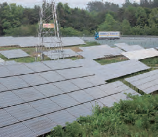
太陽光発電所
